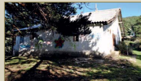
La primera construcción histórica con la que nos topamos es el chalet de la Agrupación C del Club Alpino Español, que en su época fue más conocido como 'la casa de Madinaveita. Su estado es de abandono total, aunque aún aguanta en razonable buen estado
